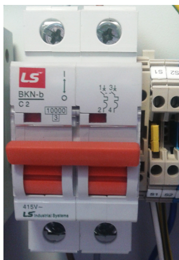
Figura 10: Magnetotérmico bipolar del circuito de alimentación auxiliar.
