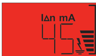
Figura 17: Pantalla de fuga con prealarma
